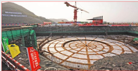
La centrale AP-1000 de 3 ème génération - Sanmen
